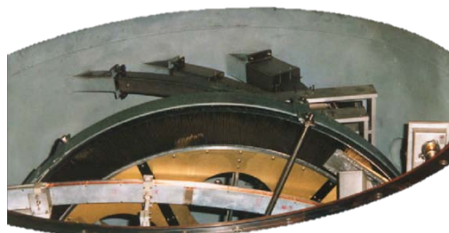
Figure 1.5 : Vue rapprochée de la turbine à l'intérieur de son enceinte
