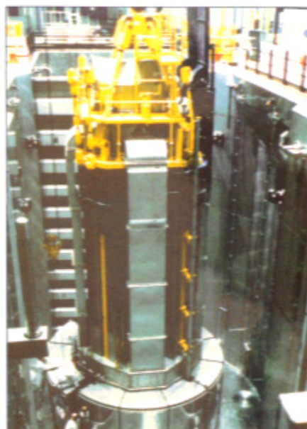
Ventilation des mécanismes de barres
